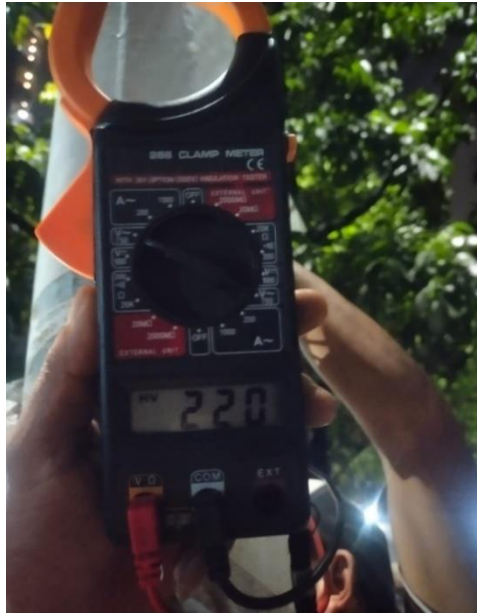
Gambar 4. 3. Pengukuran Tegangan Lampu SON
