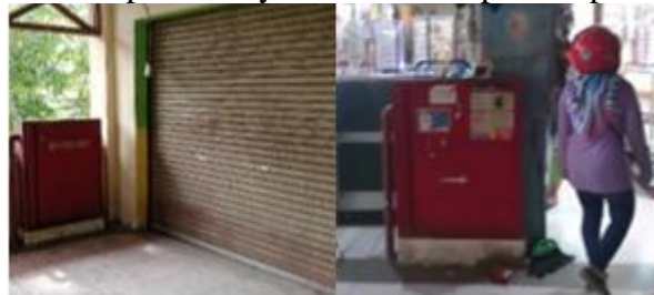
Gambar 20. Hidran Air Sumber: Dokumen Pribadi
