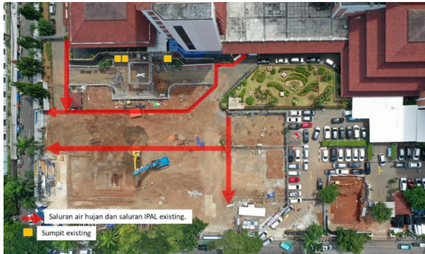
Gambar 5. Survey Saluran Beton Bertulang Eksisting sebelum Pembongkaran Dilakukan (Sumber : Arsip Data PT. PP)
