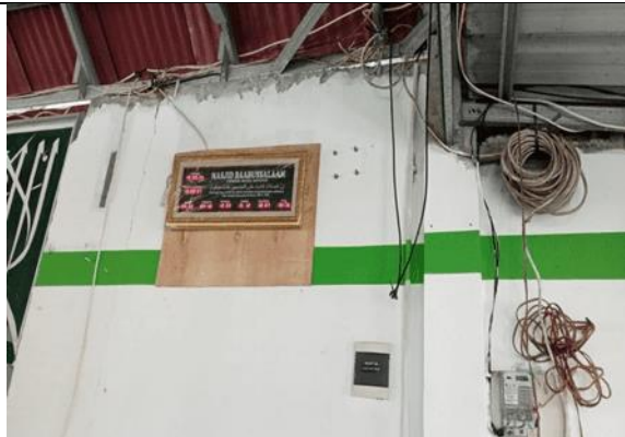
gambar1 3 instalasi dalam masjid yg belum rapi
