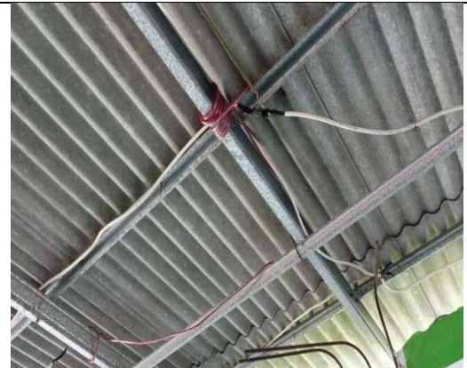
gambar1 4Tampak kabel instalasi di area lain
