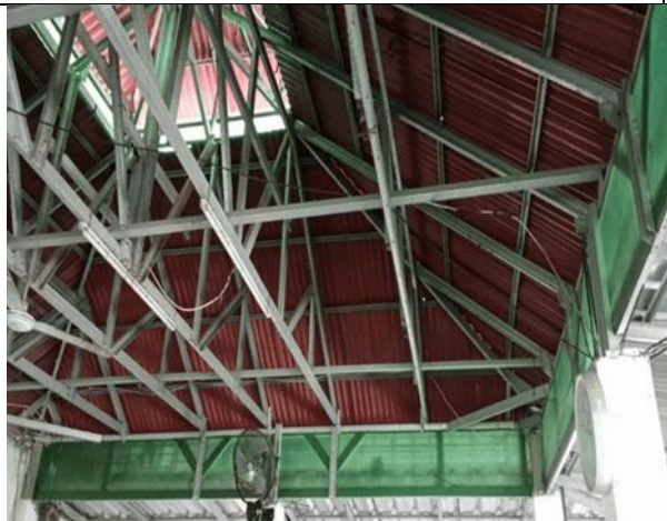
gambar1 5 Tampak instalasi ruang tengah
