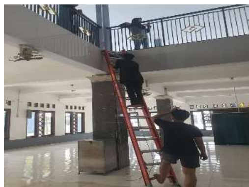
Gambar 4. Perapihan Kabel dan T-dust
