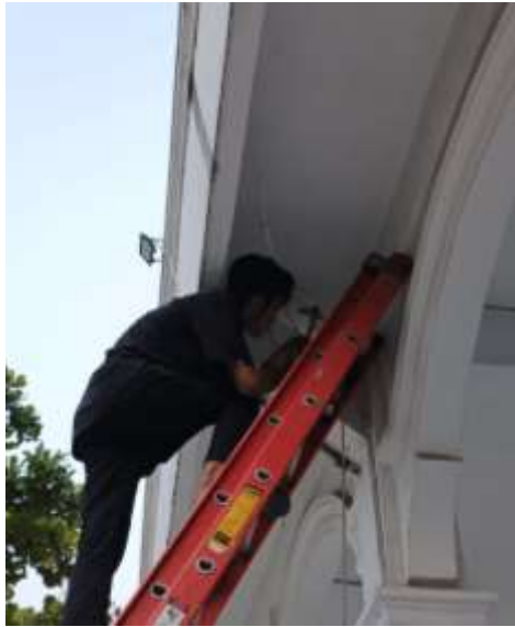
Gambar 5. Instalasi Listrik untuk penerangan area luar Masjid
